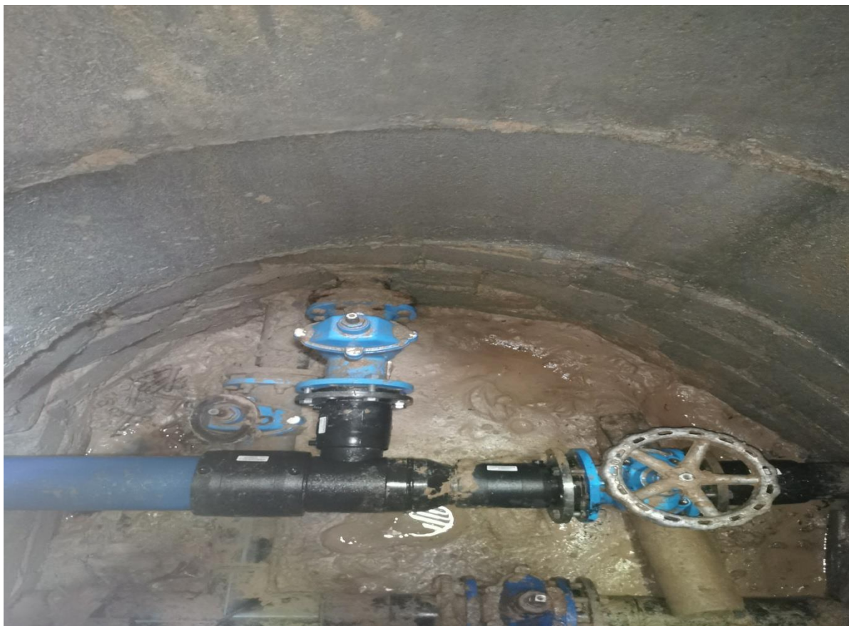
Zdjęcie nr.3. Wnętrze komory zasuw istniejącego zbiornika Kumów
